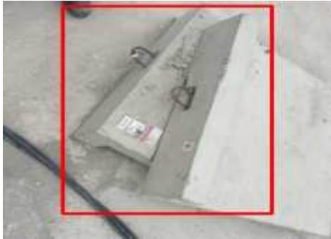
<손상이 발생한 PC콘크리트>
