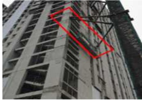
<양중장비 앵커로 인해 천공된 PC부재>
