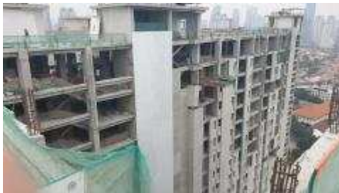
<안전난간대 설치 미흡>
