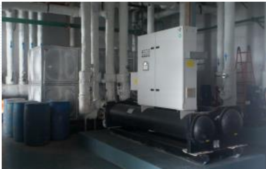
地源热泵机房
